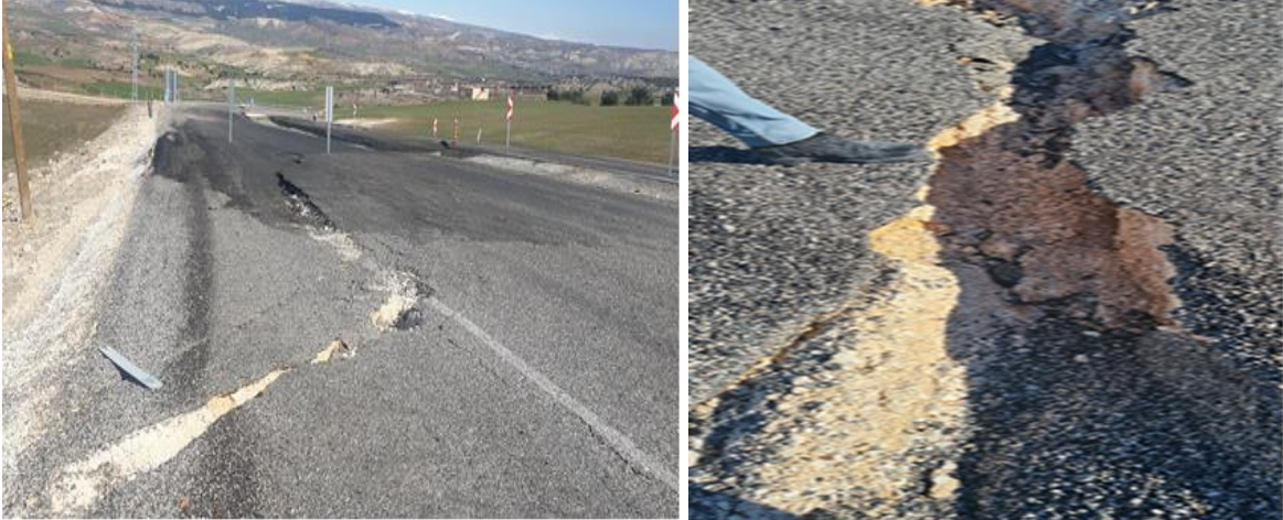
Şekil 1 – Adıyaman-Besni arasındaki yol göçmeleri (sol)
